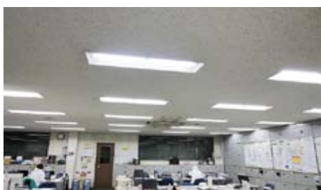
▲事務所には明るさを自動調整するタイプの蛍光灯を導入
