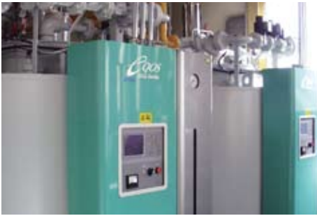
▲導入されたガスボイラー
