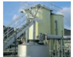
排水汚泥処理施設
