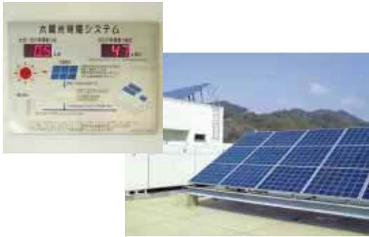
ジャム工場サイト内の太陽光発電設備
